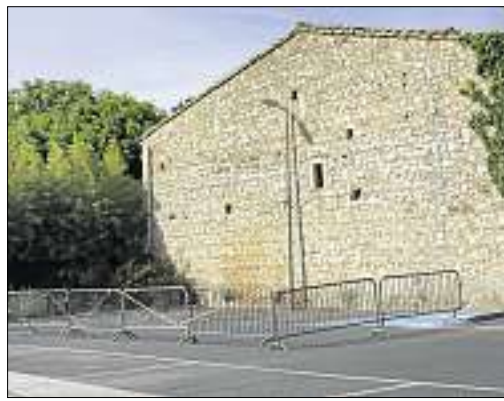
■ C'est la toiture de la grange qui serait défaillante.
